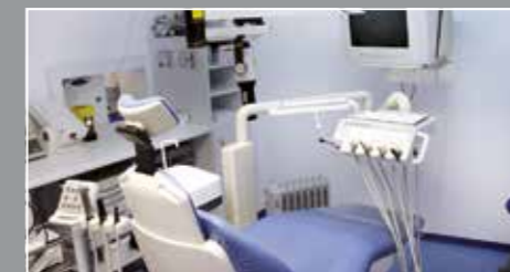
DGUV V3 Prüfung bei Ihnen vor Ort
